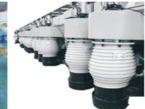
泵抽系统 pumping system
