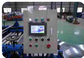
PIC 제어 캐비닛 Plc Control System
