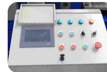
PLC 제어 캐비닛 PLC Control Cabinet
