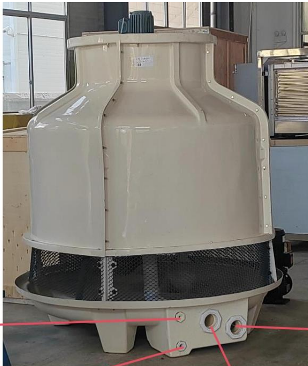
冷却塔 Cooling tower
