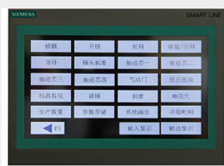
先进专业的西门子 S-7 200 控制系统 Advanced Siemens-7 200 Control System
