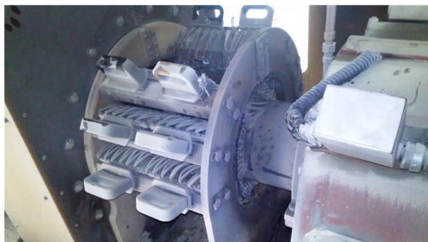
合肥电厂集电环因温度高烧毁
