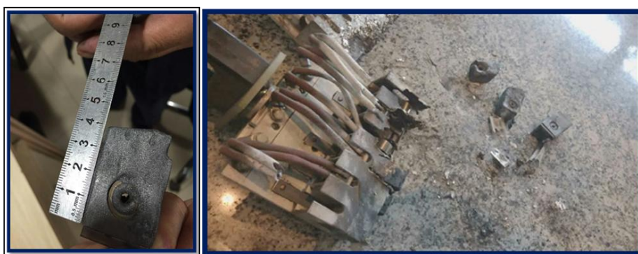
印度莎圣电厂因未及时更换碳刷过载跳火后刷握和碳刷烧毁
